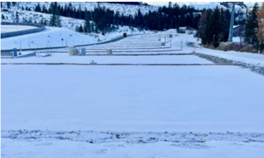
Die Arbeiten am Parkplatz Paolina sind großteils abgeschlossen. Die Beleuchtung wird heuer noch montiert. Die Bepflanzung erfolgt im Frühjahr.
